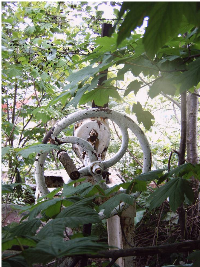
Bewegingswerk voor de rioolschuif op het buitenhoofd, ter plaatse van het buitenfront, met bedieningswiel.
