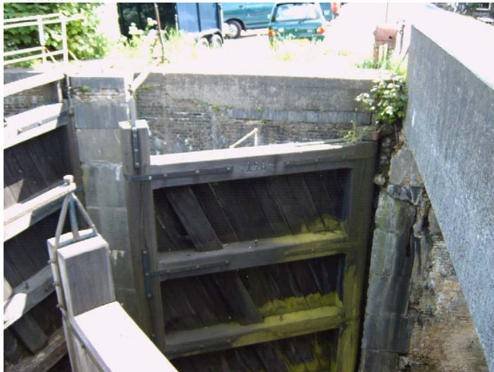
Vloeddeuren in het buitenhoofd. Rechts de beschadigde slagstijl onder de betonbrug.
