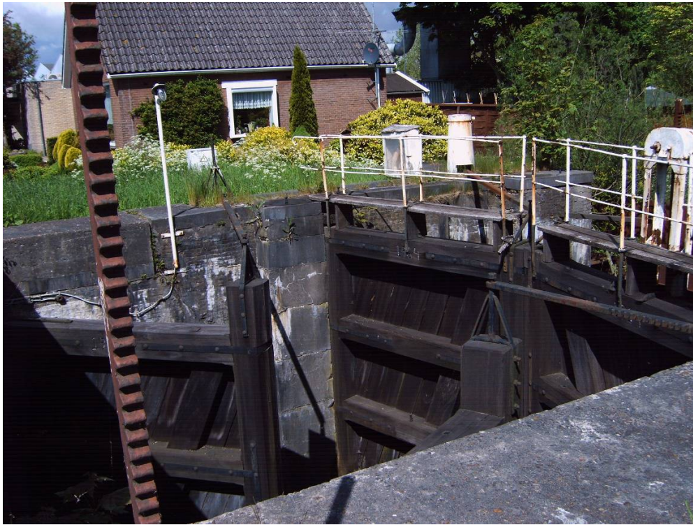
Buitenhoofd met vloed- en stormvloeddeuren. Op de achtergrond het bewegingsmechanisme voor een van de stormvloeddeuren. Rechts het bewegingswerk van de nivelleerschuif in de stormvloeddeur.
