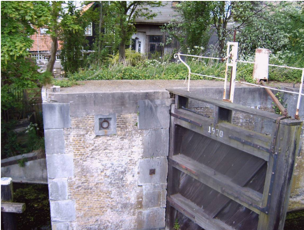
Westelijk benedenhoofd met vloeddeur, bewegingsmechanisme voor de deur en bewegingswerk voor de nivelleerschuiif.
