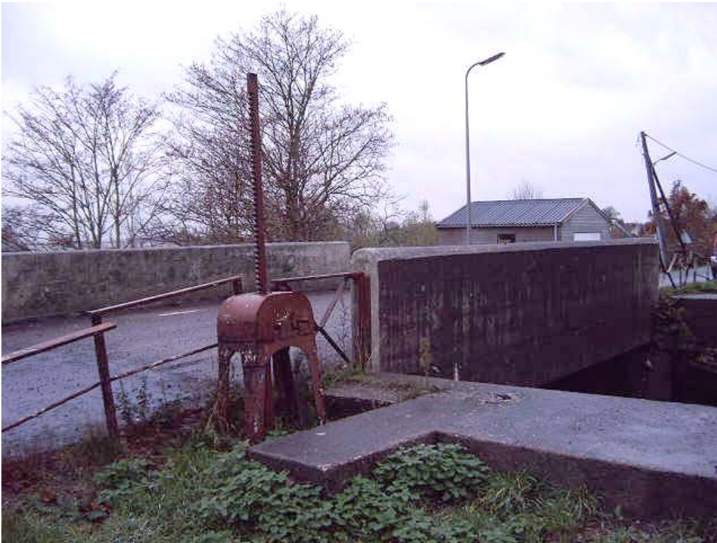
De vaste betonbrug met op de voorgrond het bewegingswerk voor de binnenschuif in het omloopriool tussen de kolk en het buitenhoofd. (herfst 2004)
