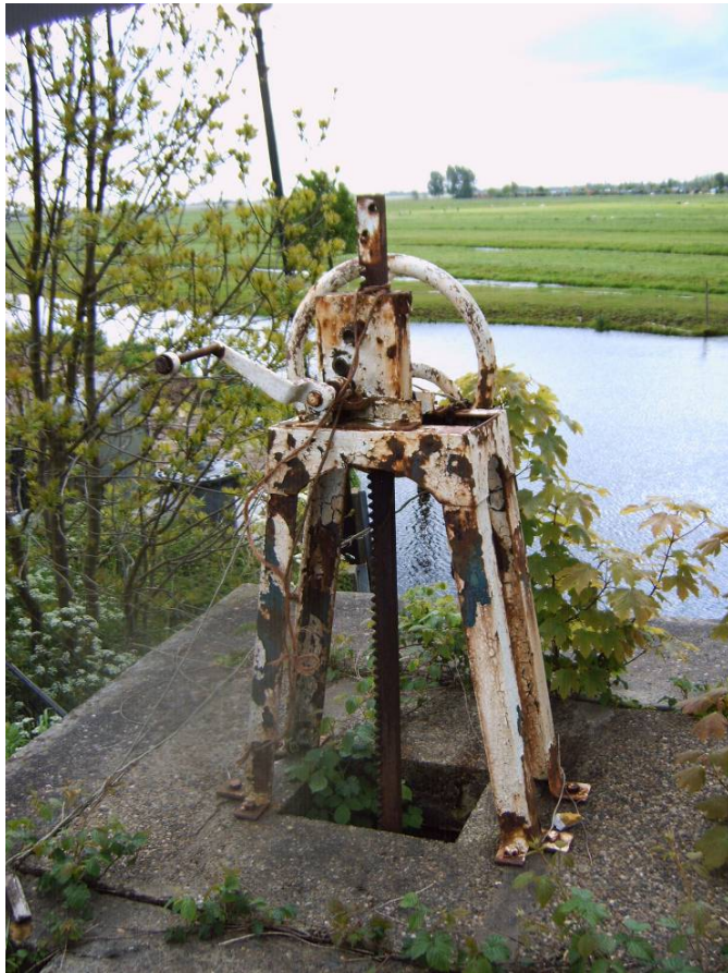
Bewegingswerk voor de rioolschuif op het binnenhoofd. Het bewegingswerk kan aan twee zijden worden bediend: met een zwengel en met een wiel. Het bedieningswiel is waarschijnlijk van gietijzer.
