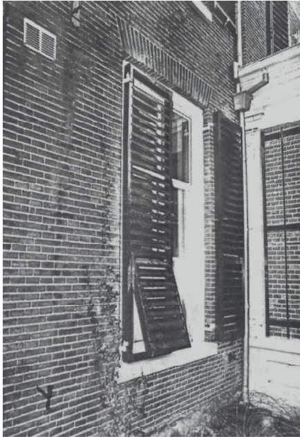
Persienne met uitklapbaar onderdeel, vermoedelijk uit omstreeks 1890. Het huis had waarschijnlijk reeds in de bouwtijd ook persiennes , die later zijn vervangen.
